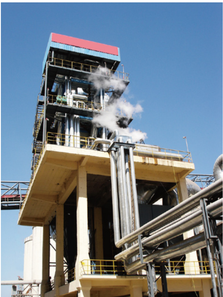
第二代纯余热电站窑头AQC余热锅炉
