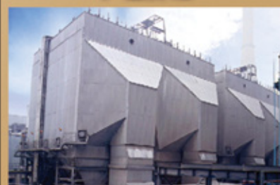
电除尘器 (ESP)
