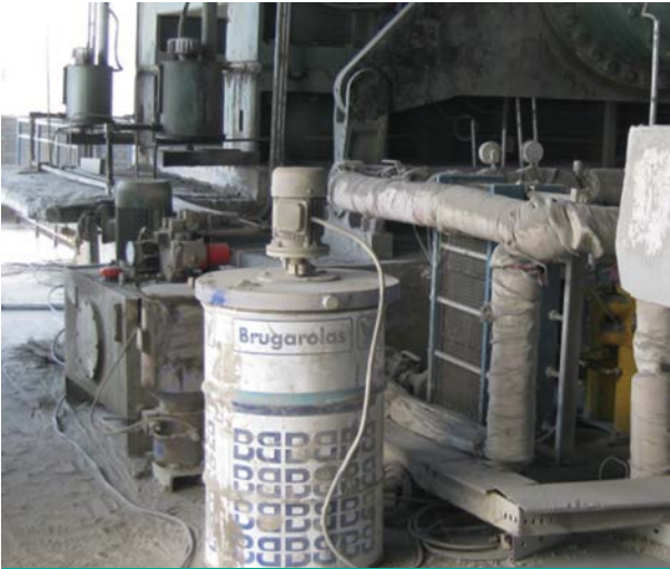
补油桶及高压泵桶未进行有效的防护，桶盖被粉尘覆盖
