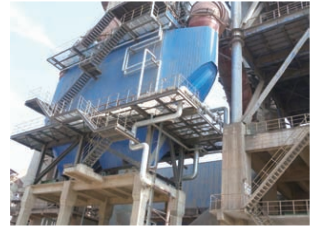
9MW低温余热发电窑尾锅炉
