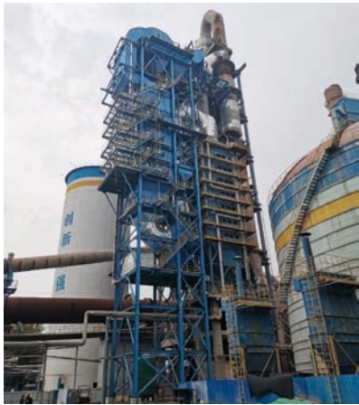
图7 长城铝业水泥“高效电聚耦合除尘+SCR宽温高效(KGC)催化技术” 2019年12月与焦作千业水泥有限公司水泥厂签订2×5000t/d熟料窑烟气脱硝深度治理系统,采用预除尘(无预除尘)+SCR宽温高效催化技术,设计选型按照高温电除尘器不投运的情况下SCR脱硝系统仍可达标运行。2020年7月底施工完毕,已投入使用, \text{NO}_x < 35\text{mg}/\text{Nm}^3 ,氨逃逸 < 2\text{mg}/\text{Nm}^3 。
